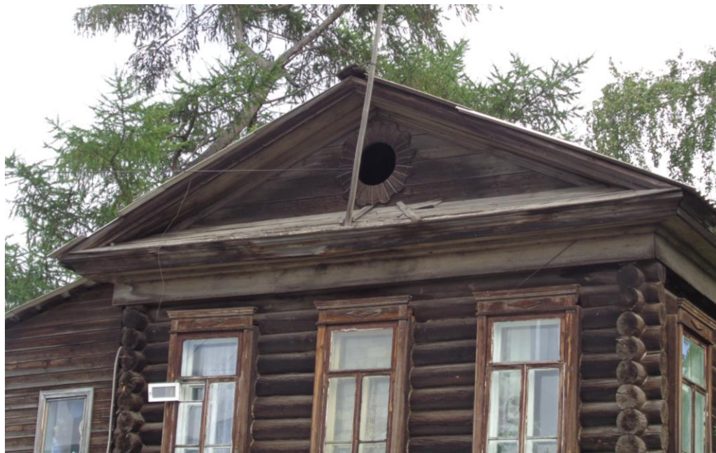
Рис. 21. Дом-флигель усадьбы купца С.Ф.Хромова и его наследников по ул.Крылова, 26а. Фрагмент фронтона восточного фасада. По состоянию на 2017 г
