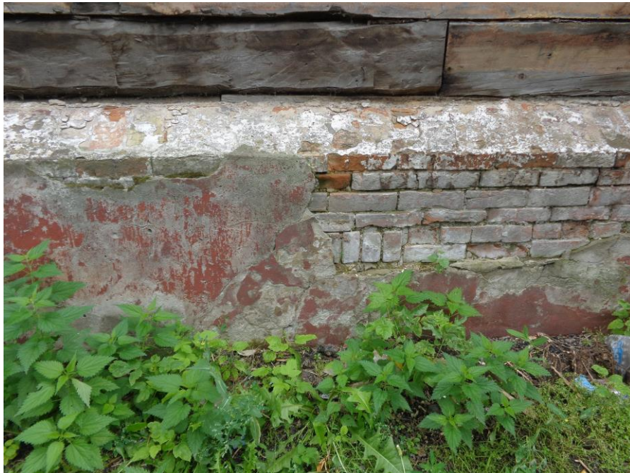
Рис. 17. Фрагмент главного усадебного дома купца С.Ф.Хромова и его наследников по ул.Крылова, 26. Фрагмент цоколя. По состоянию на 2017 г.
