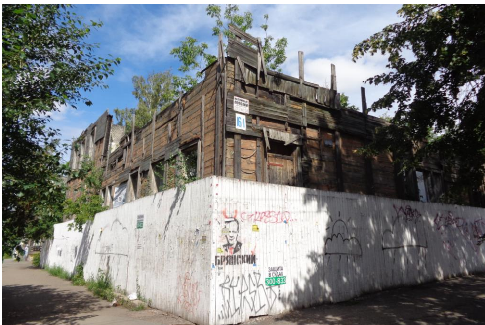
Рис. 14. Главный усадебный дом купца С.Ф.Хромова и его наследников по ул.Крылова, 26 со стороны сквера. По состоянию на 2017 г.
