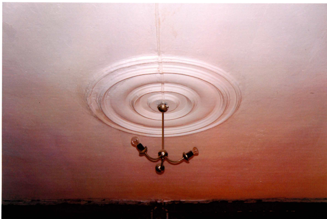
Видовая точка № 12. Потолочная розетка.
