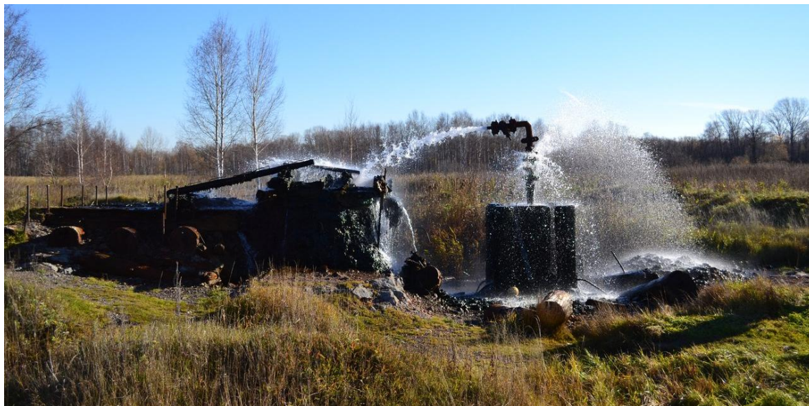
Видовая точка № 1. Общий вид скважины. (18.10.2015 г.)
