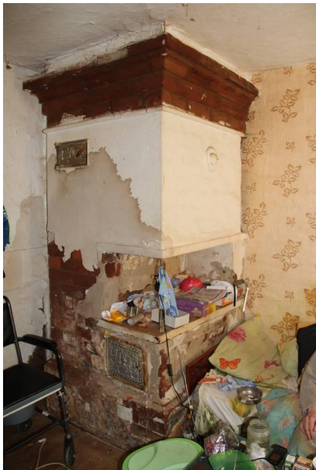
Видовая точка № 23. Печь в квартире цокольного этажа
