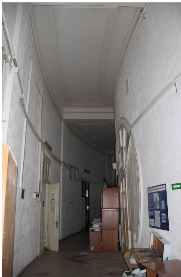
Видовая точка № 29. Коридор 3-го этажа угловой части здания, штукатурные тяги, перегородка (19.11.2020)
