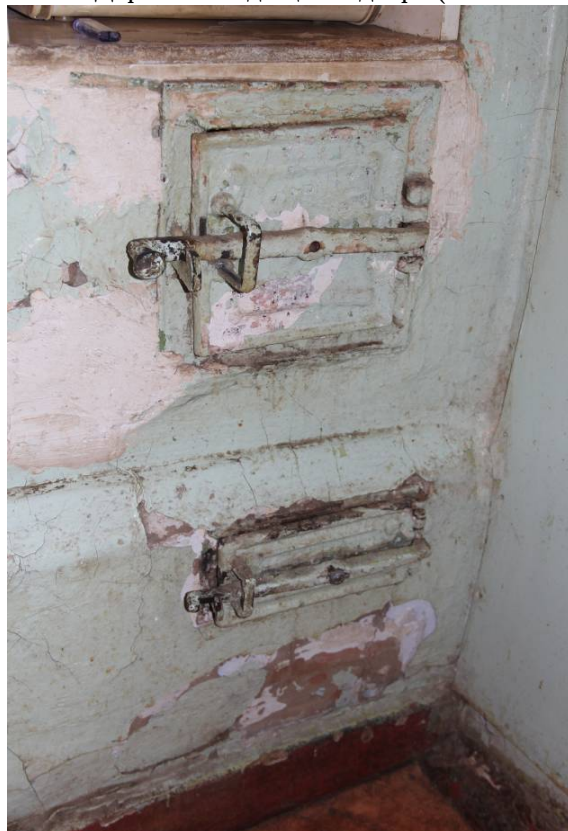
Видовая точка № 33. А. Иванова ул., 2/1. Печь в квартире 2-го этажа. Печные дверцы (28.04.2016)
