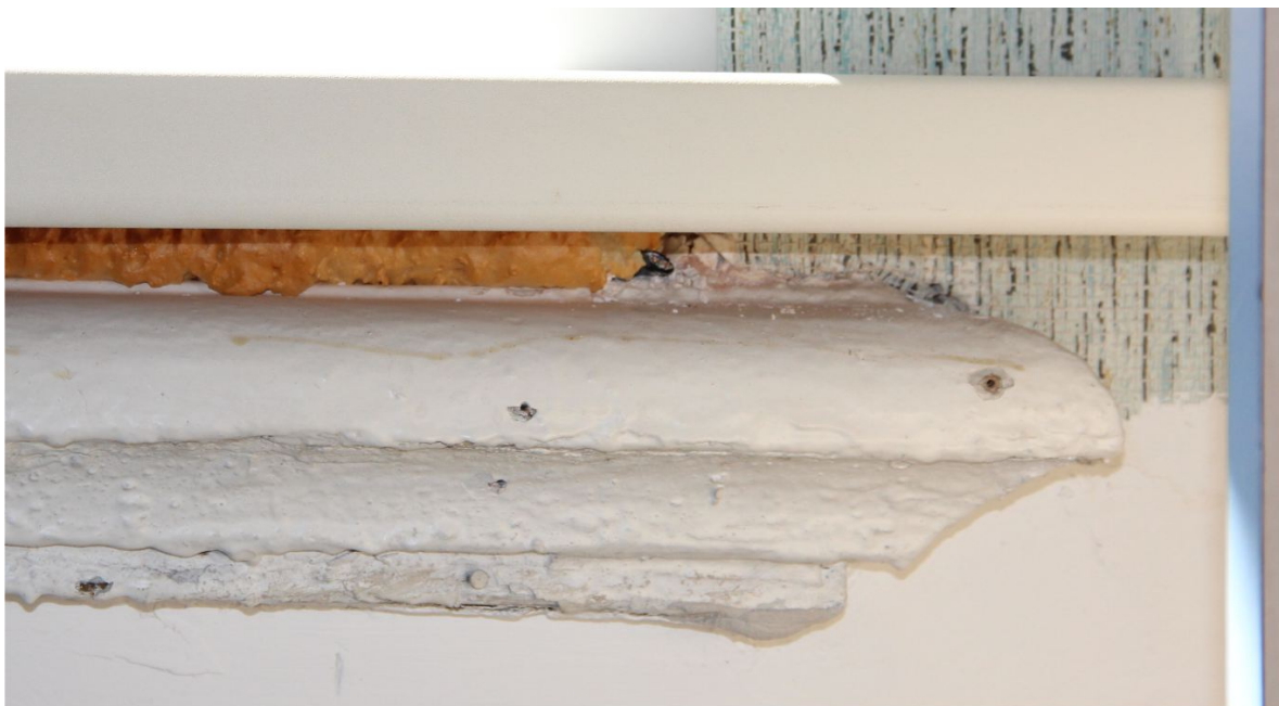
Видовая точка № 20. Деревянный профильный подоконник оконного проема первого этажа (Яблонская М.А., 25.05.2022 г.)
