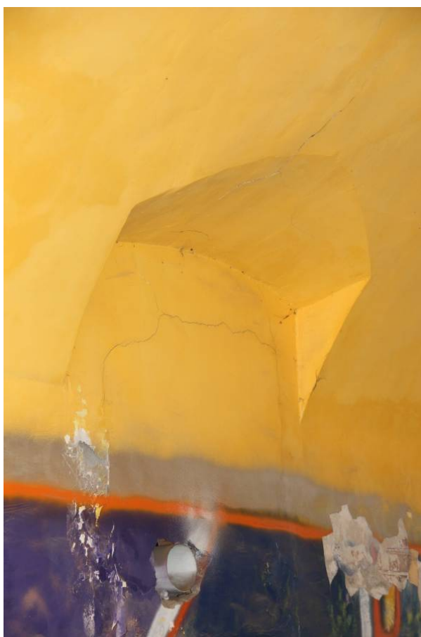
Видовая точка № 9 Распалубка в своде перекрытия проезда
