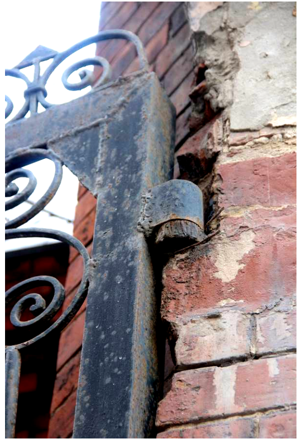
Видовая точка № 6. «Каменные ворота». Фрагмент крепления левой створки ворот на кованый подстав
